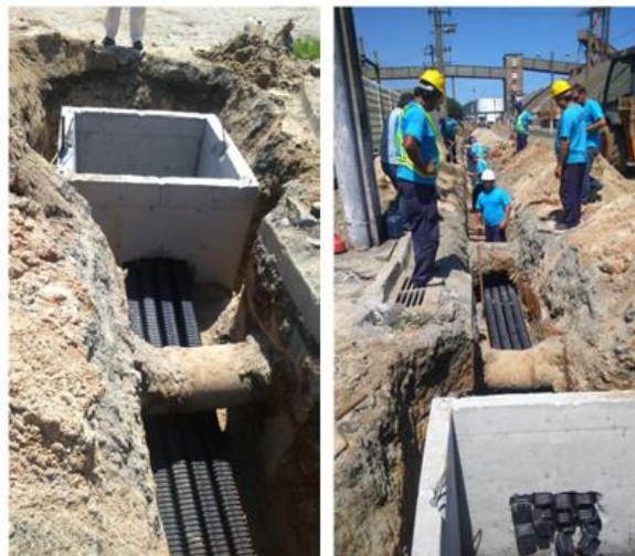
CHEGADA EM CAIXA DE PASSAGEM
