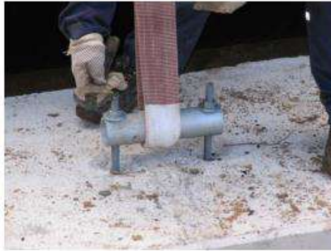
Figura 24 - Fixando e apoiando a base do tubo no fundo da vala com blocos/sapatas e cintas de ancoragem.
