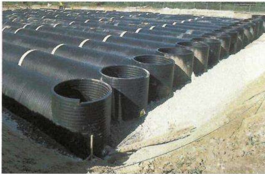
Figura 45 - Tanque de acumulação ou de retardo construído com tubos KANAWEHOLITE
